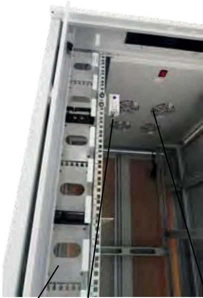
Kabelkanal, Temperatureinheit, Lüfter
